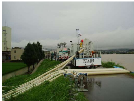
川田川樋管排水ポンプ車
