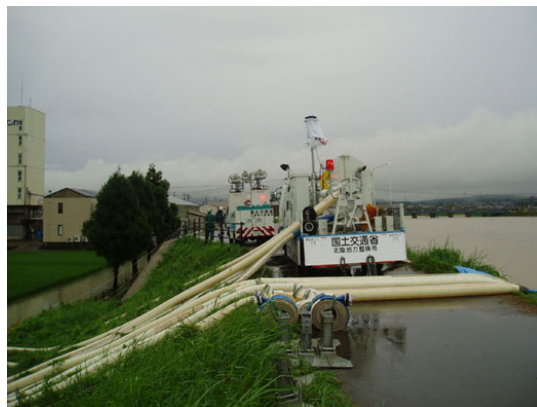
川田川樋管排水ポンプ車
