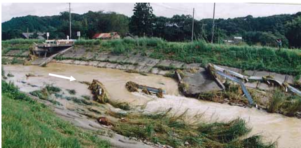
落橋後の状況
