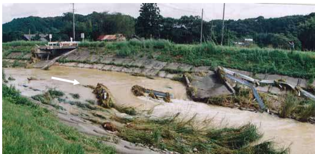
落橋後の状況
