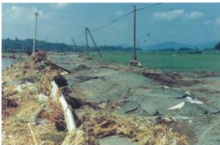
写真 4-5(8)県道南田島～豊田線の被災状況(鹿本郡植木町)
