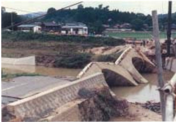
写真 4-5(2)支川和仁川 0.6km 付近(三加和町)平野橋の流失状況
