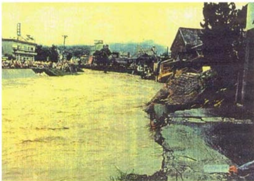
肝属川 18/200 付近（朝日橋上流左岸） 被害状況
