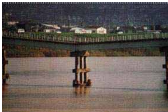
南海橋の陥没被害
