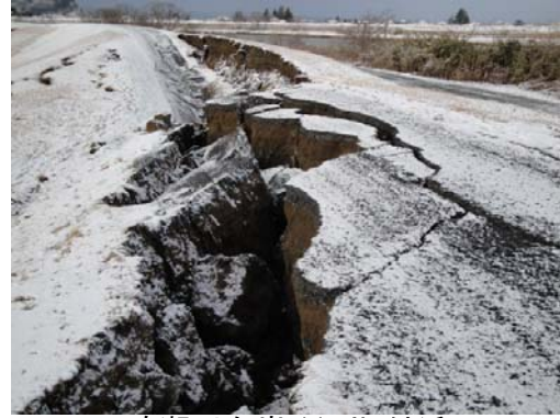
鳴瀬川左岸 11.4k 付近 (美里町二郷地先) ※地震により縦断クラック発生
