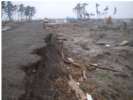
名取川左岸 0.0k 付近 (仙台市若林区藤塚地先) ※津波により堤防が流出
