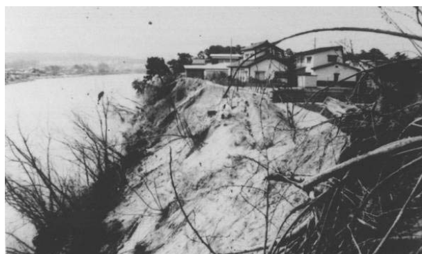
本荘市(尾花沢地区)の欠壊した河岸
