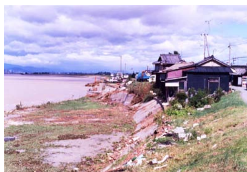
松名瀬地区(1.8K 付近) 平成2年 9 月洪水
