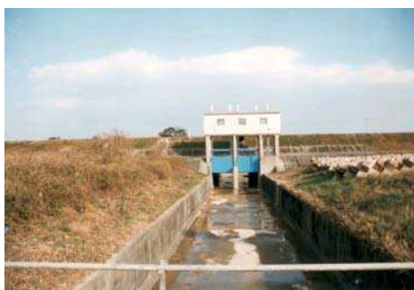
魚見用水樋管
