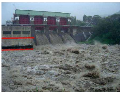
三瀬谷ダムの放流状況
