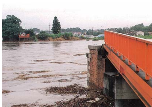
▲洪水によって流された寿橋（水戸市）
