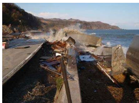
北上川右岸 0.2k 付近 (石巻市月浜地先) ※津波により堤防が流出
