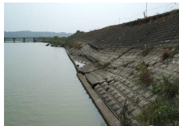
河床低下による護岸崩壊等
