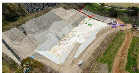
熊添川流域調整池
