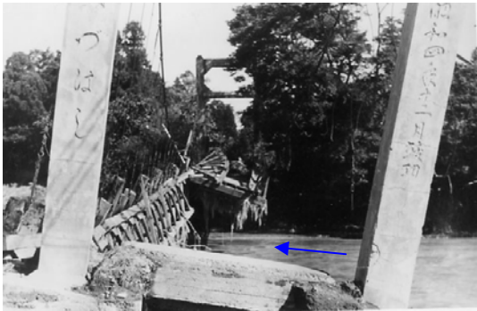
落橋した清水橋（小矢部市津沢）
