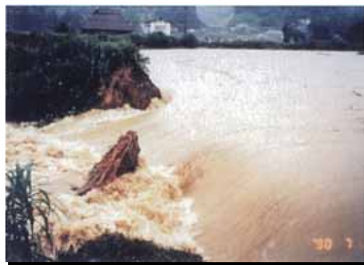
破堤氾濫状況(武雄市橋町永島地区)
