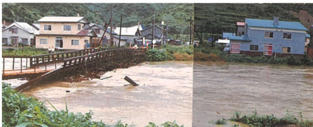
落橋寸前の大通り橋
