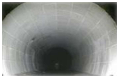
津久井導水路
