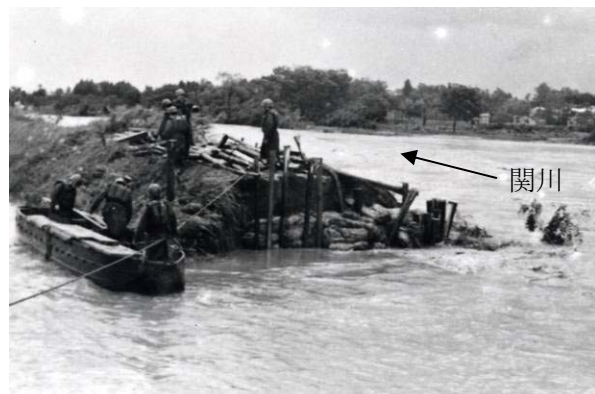
中央橋左岸破堤状況
