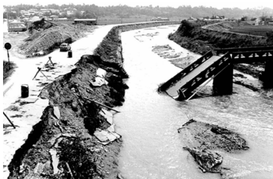
内部川 北小松橋流出状況
