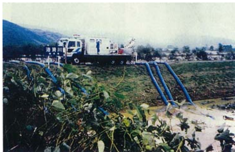
写真 4-2 ウツツ地区の内水排除状況
