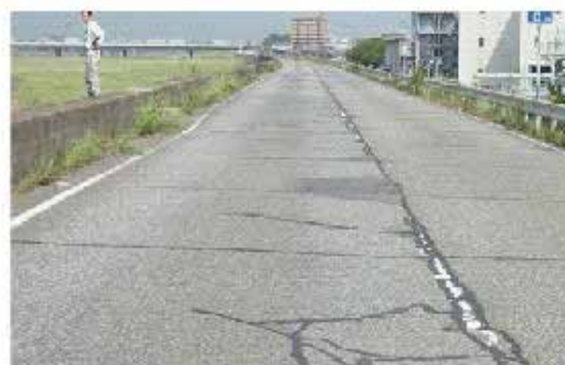
図-7.18 クラックが入った状況
