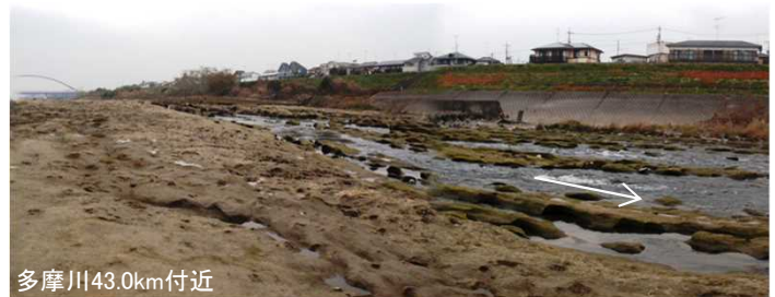
土丹の露出状況
