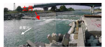
平成13年9月洪水による被災状況
