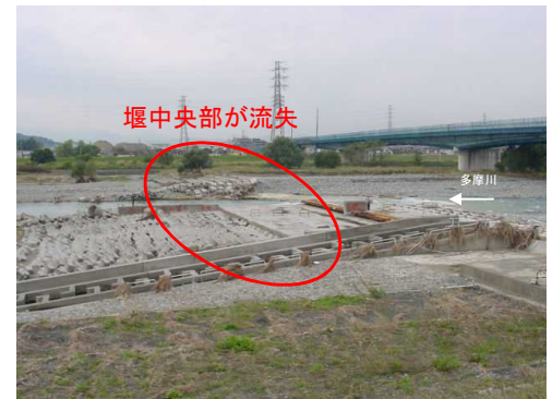
平成13年9月洪水による被災状況
