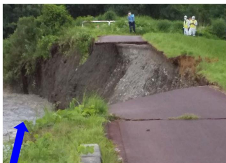
三峰川右岸 4.6k 堤防の欠損
