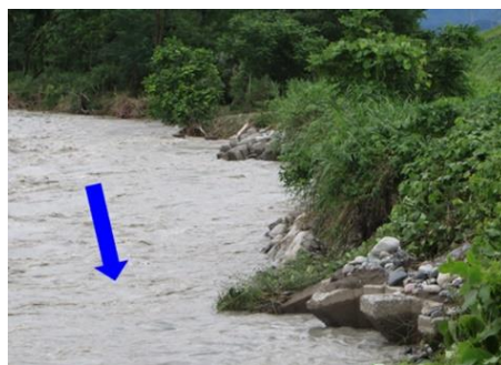
天竜川左岸 151.4k 付近 護岸一部流出
