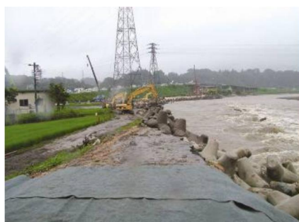
204.8km の堤防決壊状況
