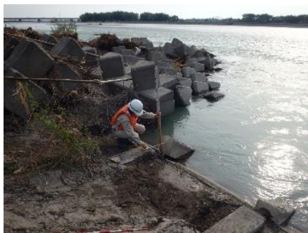
天竜川右岸 12.4k 低水護岸の沈下による護岸損傷
