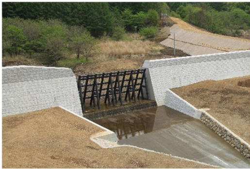
藤沢水無 鋼製スリット型砂防堰堤 (H23年度完成)(三峰川流域)
