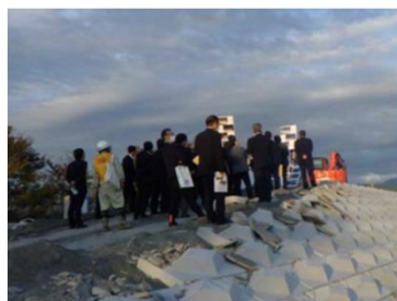
R2.7豪雨による被災箇所(三峰川)
