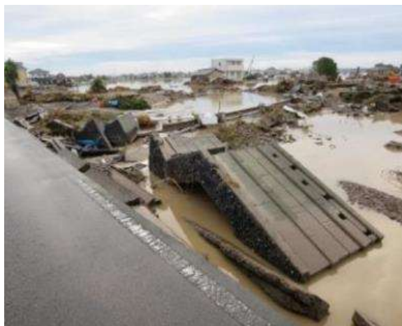
写真 4-34 決壊地点近傍家屋等流出状況 （鬼怒川）
