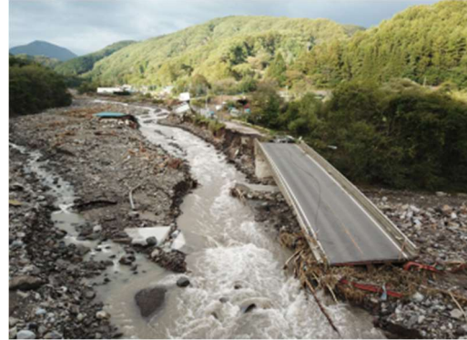
図 2-12 国道 144 号流失（鳴岩橋落橋）
