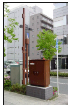
写真 9-3-1 浸水検知センサー (新横浜駅周辺)
