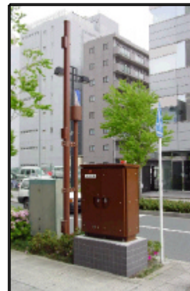
写真 9-3-1 浸水検知センサー（新横浜駅周辺）
