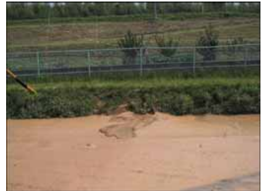
漏水状況 (右岸 38.8k 付近) 安永川水路横の堤内側の吹き出し穴
