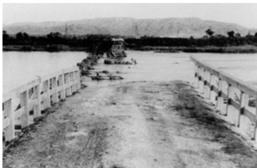
美矢井橋の被害（昭和34年 岡崎市） 美矢井橋は左岸より大半が流出した。
