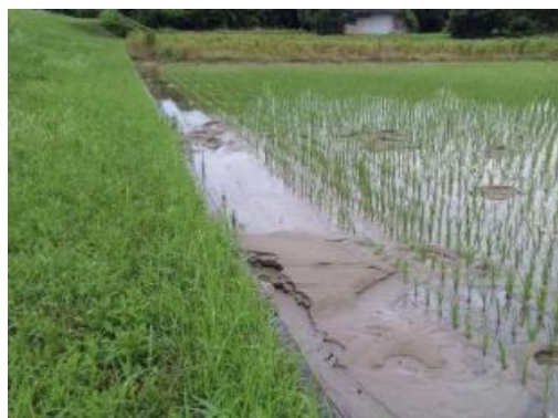
基盤漏水(吉井川右岸 8K400 付近)
