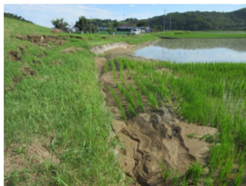
基盤漏水(吉井川右岸 13K000 付近)
