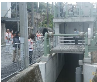
内水排水機場
