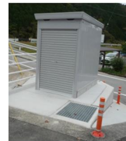
内水排水ポンプ
