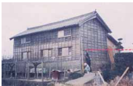
豊田宅の洪水痕跡(北島町)
