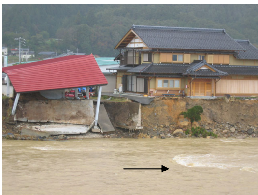
上流部被災状況 (高山市上切町)
