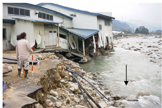
上流部被災状況 (高山市清見町)
