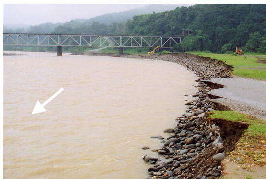
河岸侵食状況 (富山市城生)
