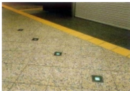
写真 9-1 光点滅走行式避難誘導システム
