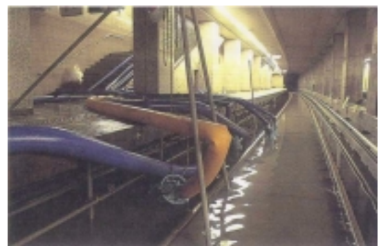
写真 1-4 地下鉄名城線平安駅でも線路が冠水
