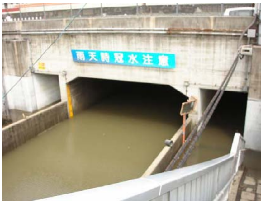
図 2.5 アンダーパス冠水の事例(埼玉県幸手市) [2]
