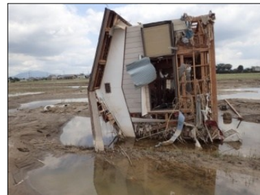
堤防決壊による家屋の倒壊
