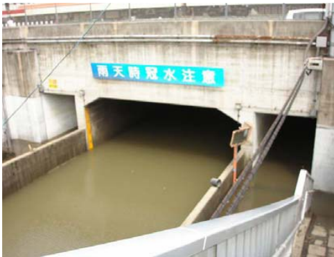
図 3-7 アンダーパス冠水の事例
