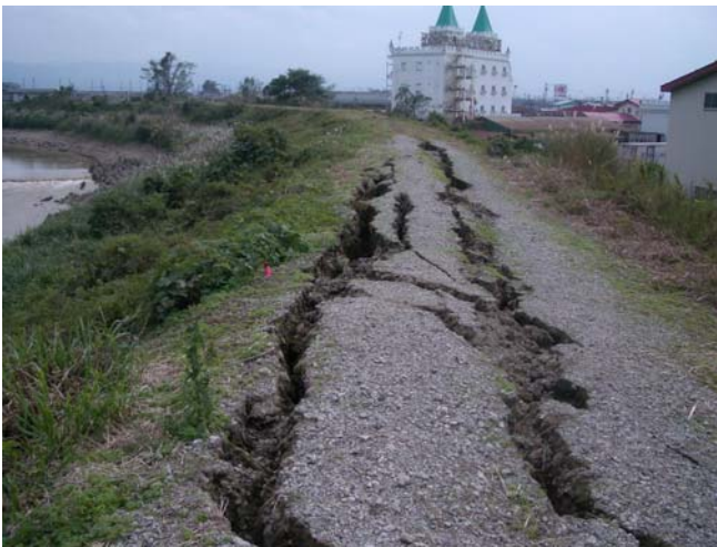
【クラックが深く刻み込まれた堤防 （新潟県中之島町（刈谷田川））】
