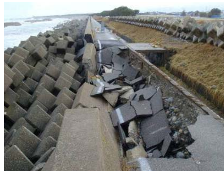
激しい高波により海岸堤防等が倒壊
