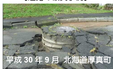
【道路の被災事例】
