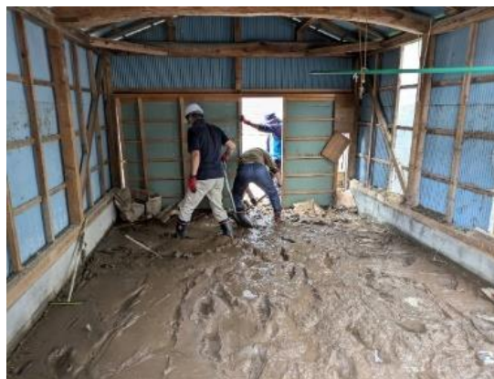
ボランティアによる土砂撤去状況
