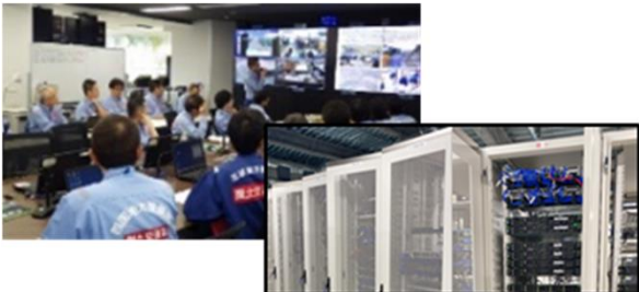
バックアップ施設として必要な表示設備、ネットワーク機器、電源設備等を整備
