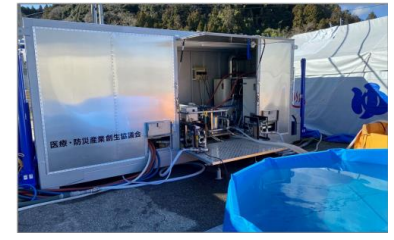
ボイラーコンテナによる入浴支援
