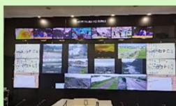
防災センターでの現地映像 等の配信環境の増強
