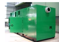
非常用発電機
