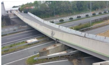
緊急輸送道路上の橋梁の崩落
