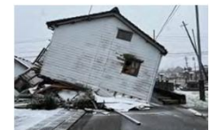
能登半島地震での木造住宅の被害
