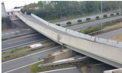
緊急輸送道路上の橋梁の崩落
