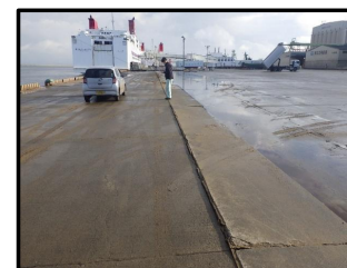
液状化・段差が発生 (八太郎3号ふ頭 フェリーターミナル)
