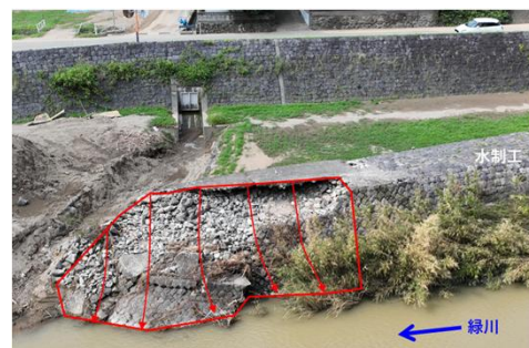
水製の被災状況
