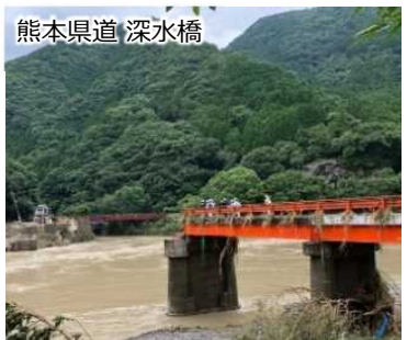
橋梁流失 (5ヶ月以上の通行止め)
