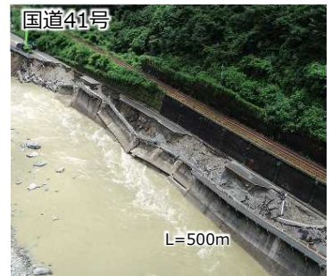
道路流失 (1ヶ月半の通行止め)
