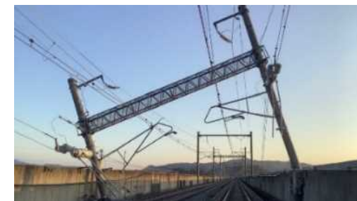
東北新幹線の電柱傾斜 (令和4年3月の福島県沖地震)
