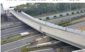
<緊急輸送道路上の橋梁の崩落>
